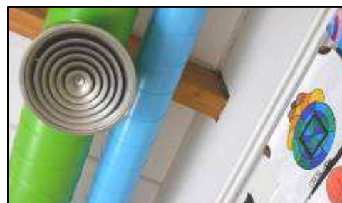
Bouche d'aération - M3E Saint-Fons © ABCD-Durable
