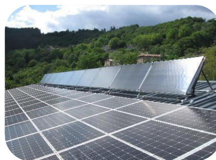
Exemple des centrales photovoltaïque et thermique Aurance Energies chez Ardelaine (Ardèche)
